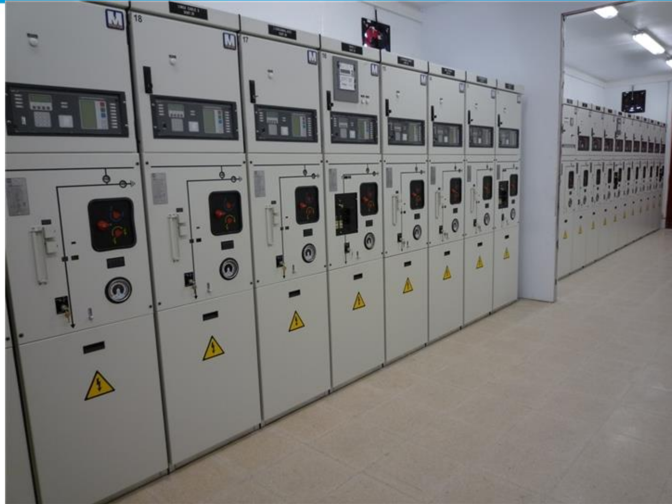
Diseño de Subestaciones de Potencia
